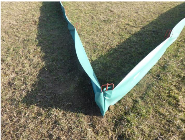
Abbildung 3: Undichte Überlappung und durchhängende Stelle.
