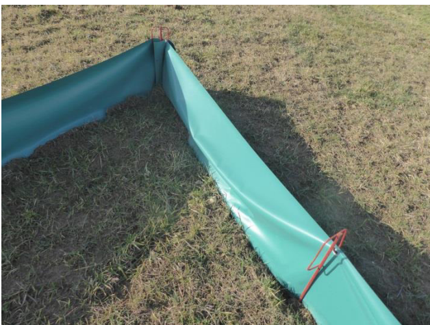
Abbildung 5: Undichte Überlappung und durchhängende Stelle.
