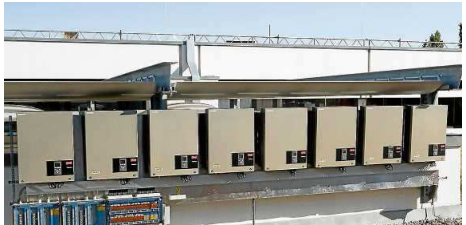
Auch Photovoltaikanlagen bieten Einsparpotenziale.
